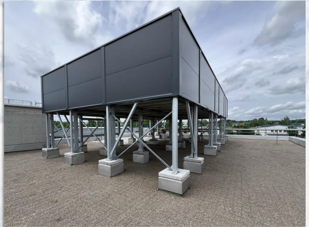
Luftkühler der Wärmepumpe
