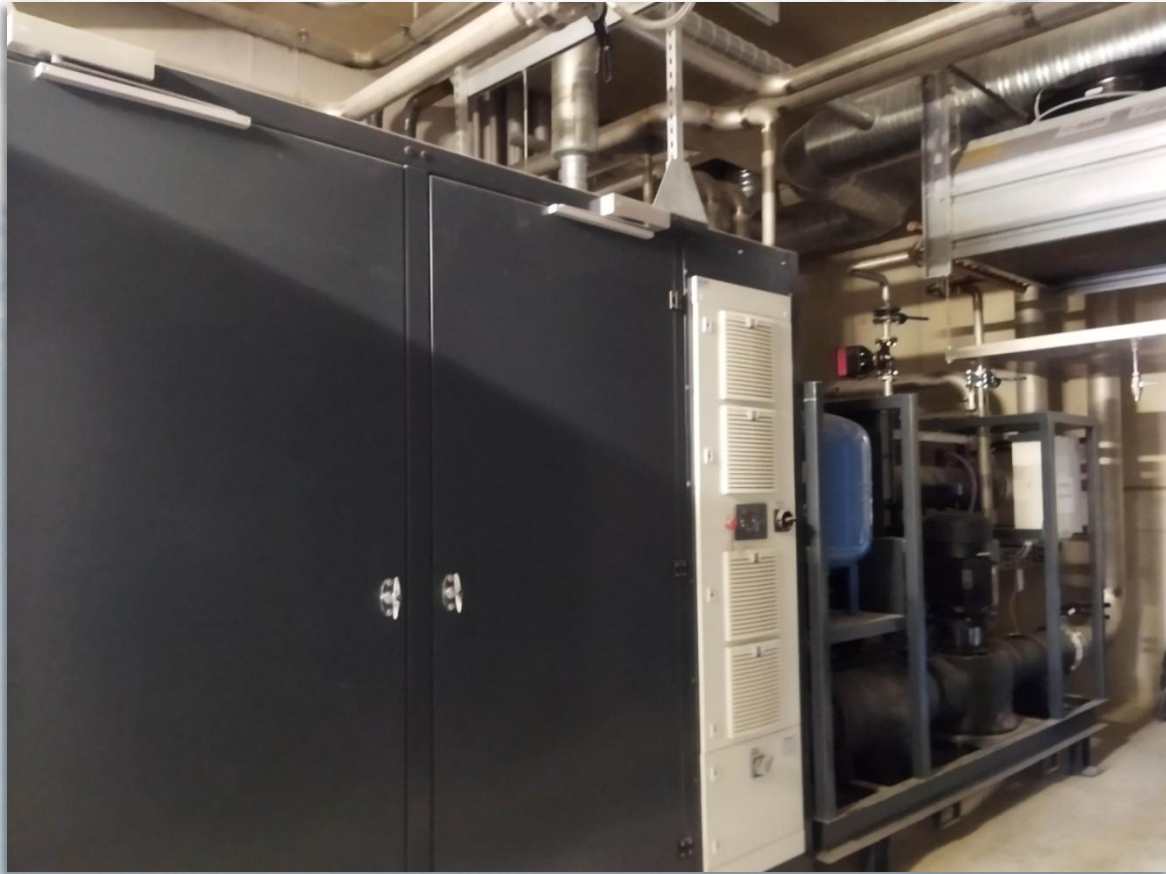
Schaltschrank der Wärmepumpe
